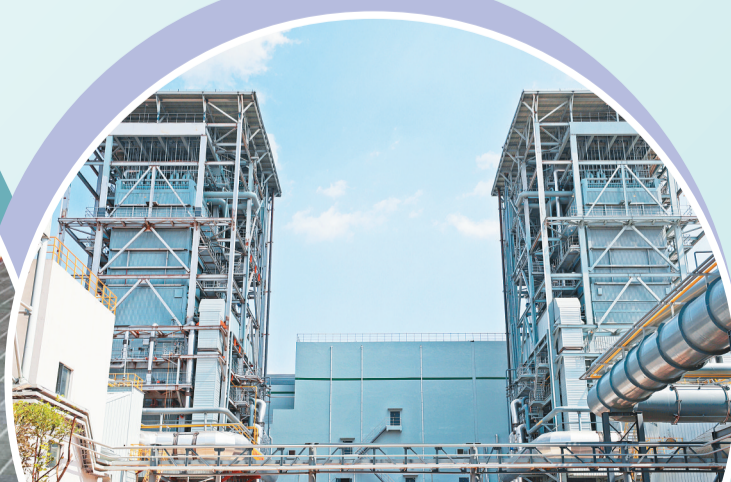
煤气发电1号锅炉、2号锅炉。
